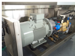
Système de pompage
