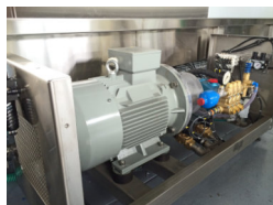
Sistema de bombeo
